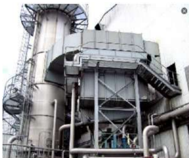
Image 3 : Condenseur de récupération de la chaleur latente
