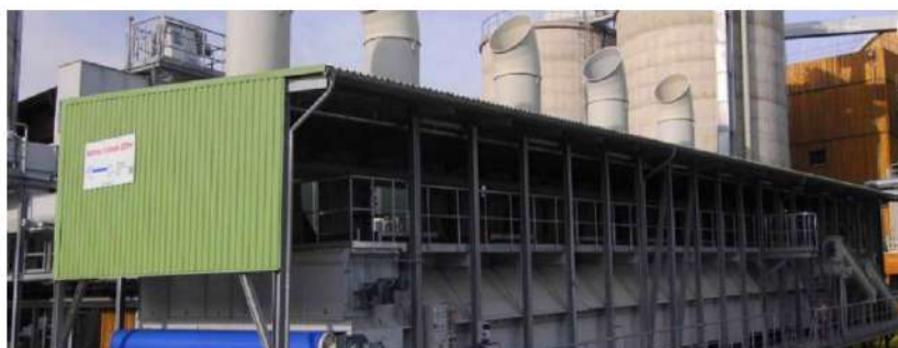
Image 4 : Sécheur basse température à bande
